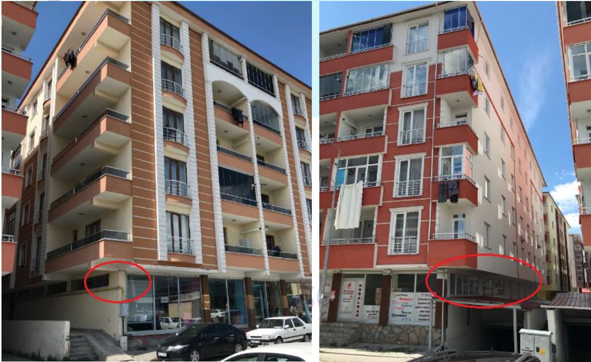
Görsel 5. Ardahan yapı stoğunun kısa kolonlara sahip örnek yapılar.
