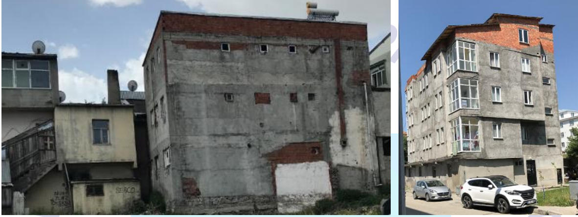
Görsel 4. Ardahan yapı stoğunun kötü kaliteye sahip örnek yapılar.
